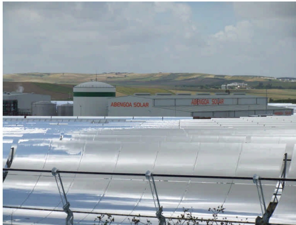
XiNa Solar One – 100MW trough
